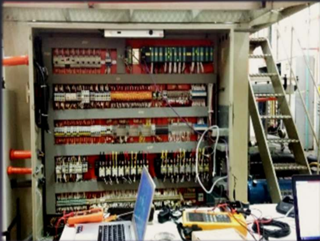
AUTOMATIZACIÓN Y CONTROL
